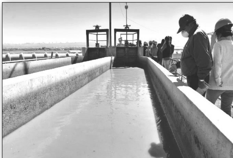
Fotografía 9.5.3 Planta de tratamiento de aguas residuales PUCHUKOLLO, ciudad de El Alto
